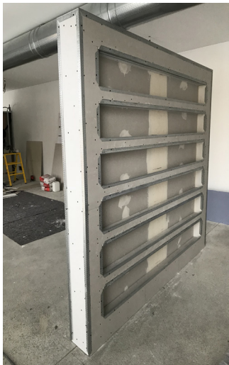
Parete per esposizione in un showroom
